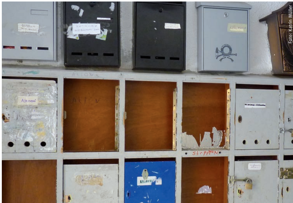
Die meisten Briefkästen haben keine Abdeckung mehr und die ursprüngliche Fassade der Wände lässt sich nur noch erahnen.
